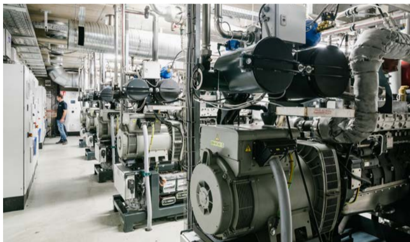
Markus Eirenschmalz in der neuen Halle mit den Holzgas-BHKW
